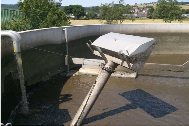
Lugar de instalación: Friedlos, Alemania.
