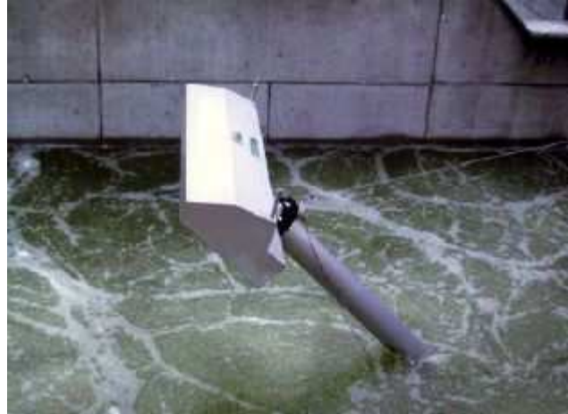
Decantador a nivel máximo de operación
